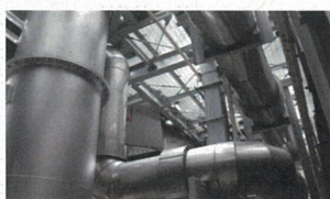
プラント配管
